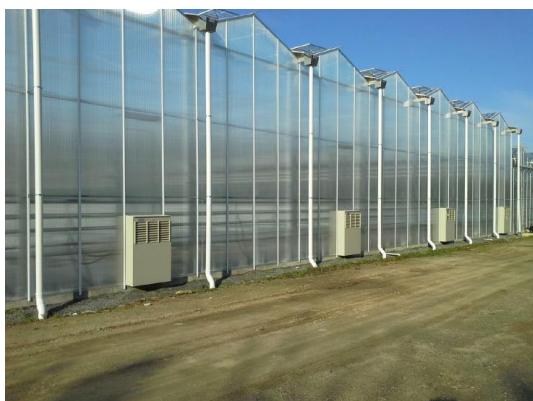
Abbildung 13 Ansicht von aussen von AVS units (Quelle: van Dijk heating)
