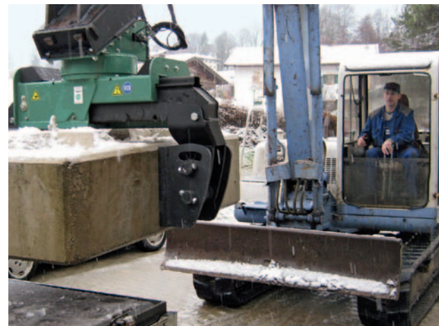
Baustellen sind Spitzenreiter in Unfallstatistiken.
