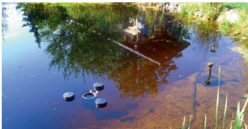
Mängel im Gartenbau: Diese 220-Volt-Pumpen im Nutzbereich sind zur Wasseraufbereitung denkbar ungeeignet ...,
